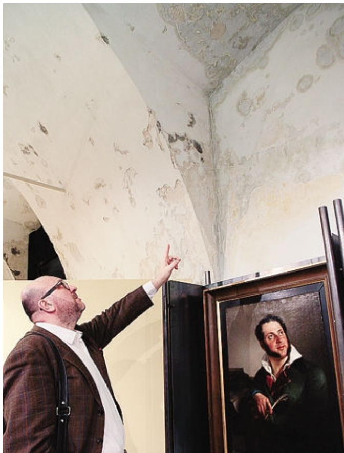
Il direttore Visentin indica i danni causati dalle infiltrazioni
